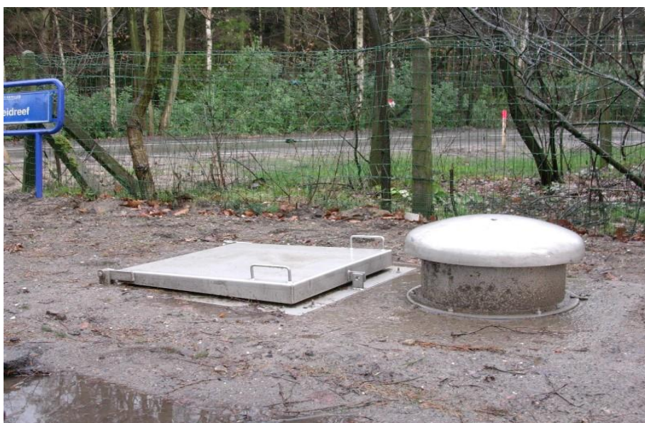
Figuur 14: Biofilter ter hoogte van de lozing (Bron: Grontmij)
