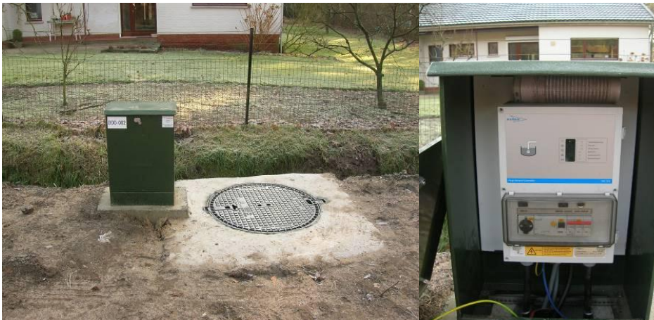
Figuur 12: Kleine schakelkast op betonnen sokkel (Bron: Grontmij)
