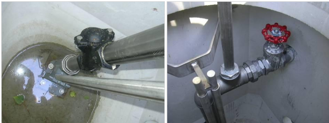
Figuur 11: Stijgleiding met balkeerklep (l) en afsluiter (r)
